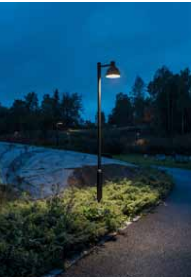
I hagene. Eksempel mast med tradisjonell armatur
