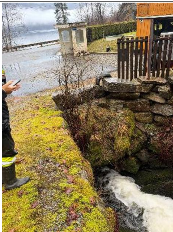
6-2: Ved tilstopping eller oppstuvning vil veien oversvømmes. Men god overdekning. Noen egen løsning fra eier av bolig, der rør stikker ut. Usikker på formål og påvirkning.
