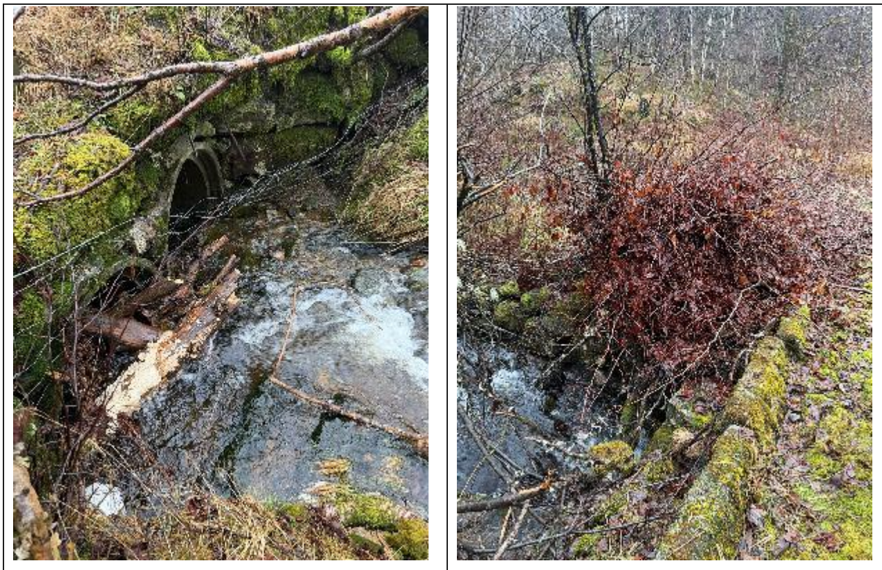
Figur 1-2: Tilstopping ved kulverter observert på befarings
