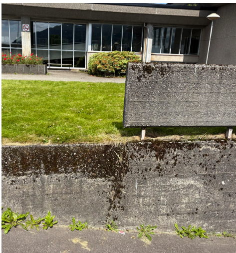
Figur 63: Eksisterende rekkverk og høydeforskjell på de ulike nivåene.
