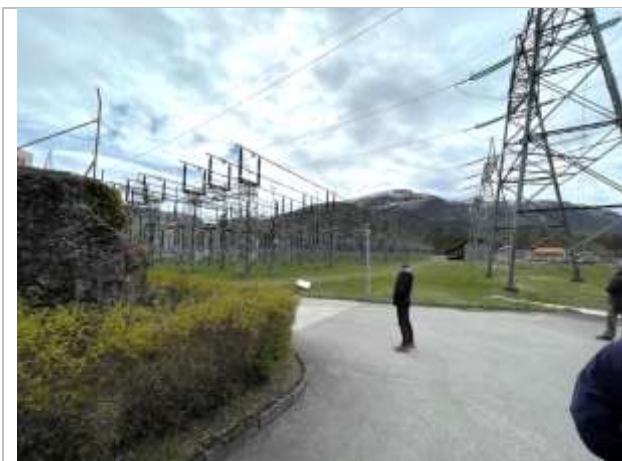
Figur 32 Statnett sin trafostasjon på Longabakka i enden av Austrheimsvegen ; Foto:Norconsult AS
