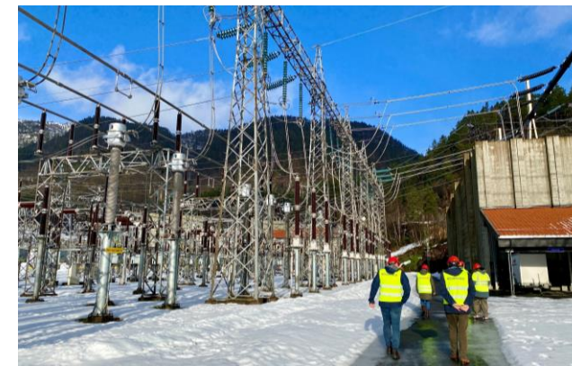
Statnett – Linje- og trafoanlegg (2++ mrd)
