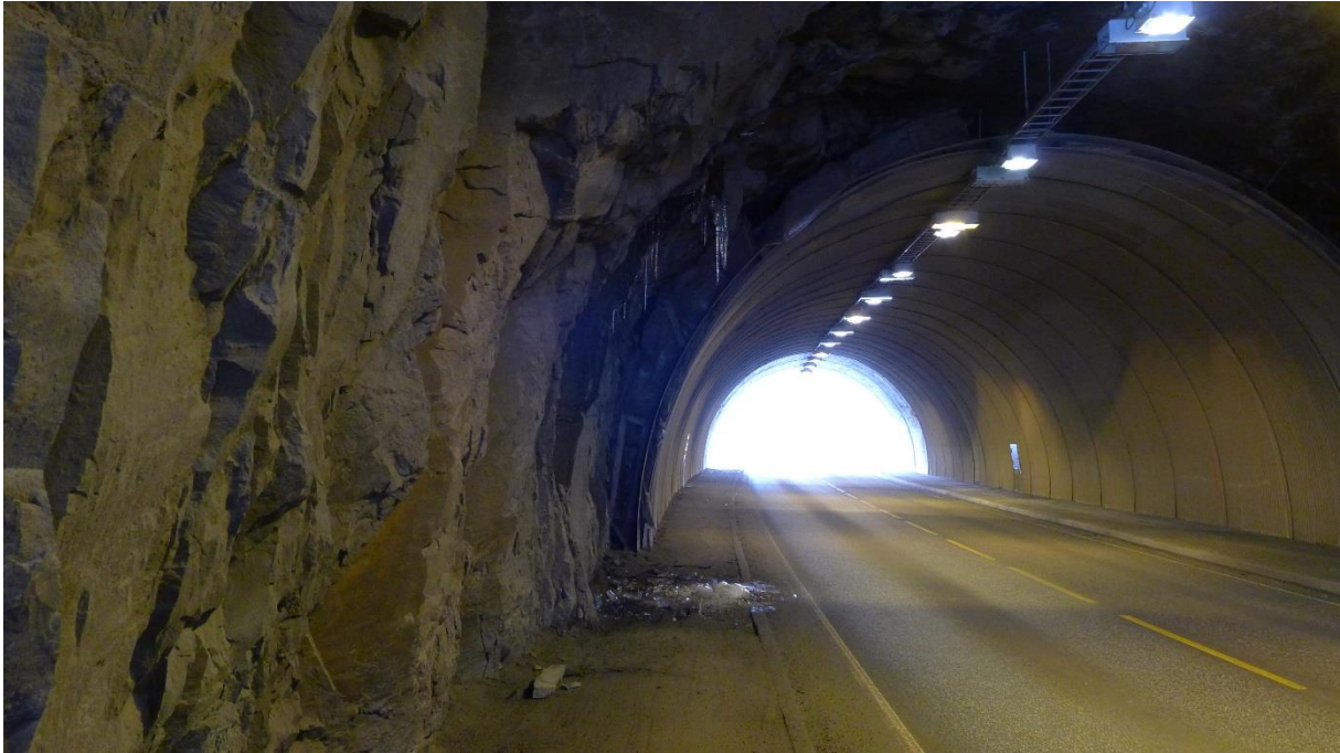
Bilde 8 Bilde av tunnelhvelv inne i tunnel sett mot vest. Det er registrert is på bankett rett før overgang til vann- og frostsikringshvelv.
